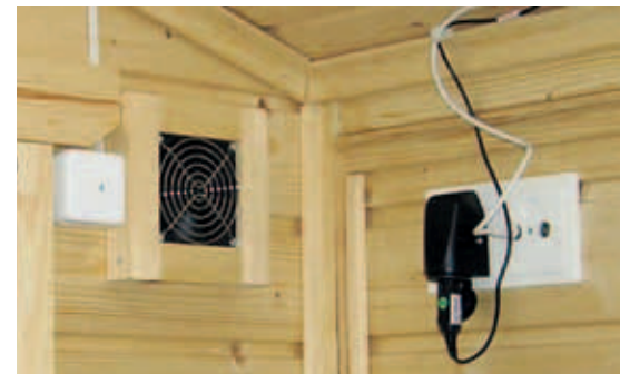
Keskellä erittäin pienikulutuksinen, mutta tehokas ilmanvaihtomuri, jonka vasemmalla puolella valkoinen kytkinrasia. Oikealla on tupakansytyinpistoke pinta-asennuksena sekä antennijohto.
