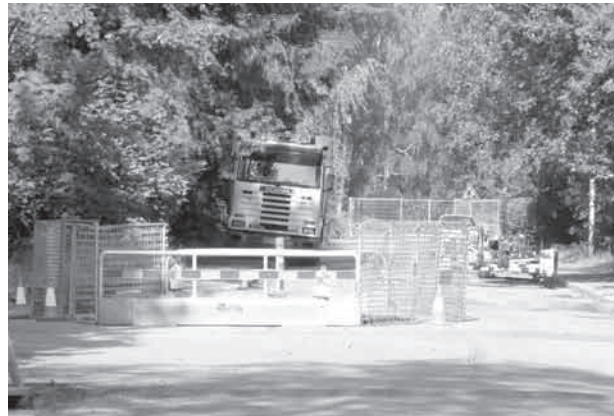
Perusparannettavat kaivot ja putkien liitokset sijaitsevat usein keskellä risteystä. Niin tässäkin Tiirasaarentien ja Kyyluodontien risteyksessä.
